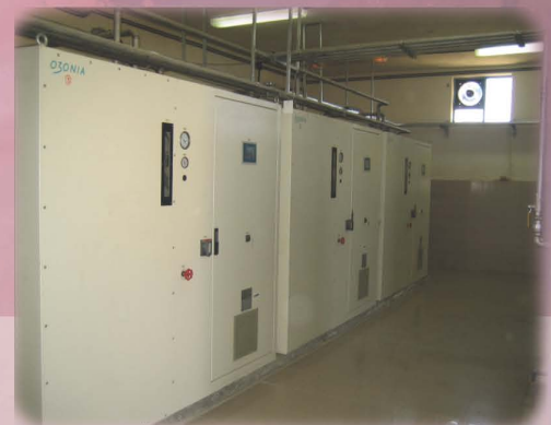
سیستم ازن زنی نصب شده به همراه سیستم تامین هوای ورودی به ظرفیت ۱۲ کیلوگرم ازن در ساعت در تصفیه خانه جدید آب شهر همدان
