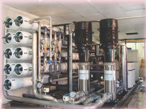
پروژه نیروگاه طرشت تهران جهت آب دمن بویلرها به ظرفیت ۷۲۰ متر مکعب در شبانه
